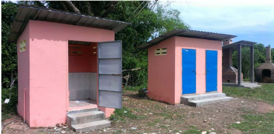
រូបភាពបង្គន់អនាម័យទើបតែជួសជុល និងឡដុតសំរាមសំណល់វេជ្ជសាស្ត្រថ្មីបានដាក់ឲ្យប្រើប្រាស់នៅមណ្ឌលសុខភាពកណ្តៀង ស្រុកកណ្តៀង ខេត្តពោធិ៍សាត់។
